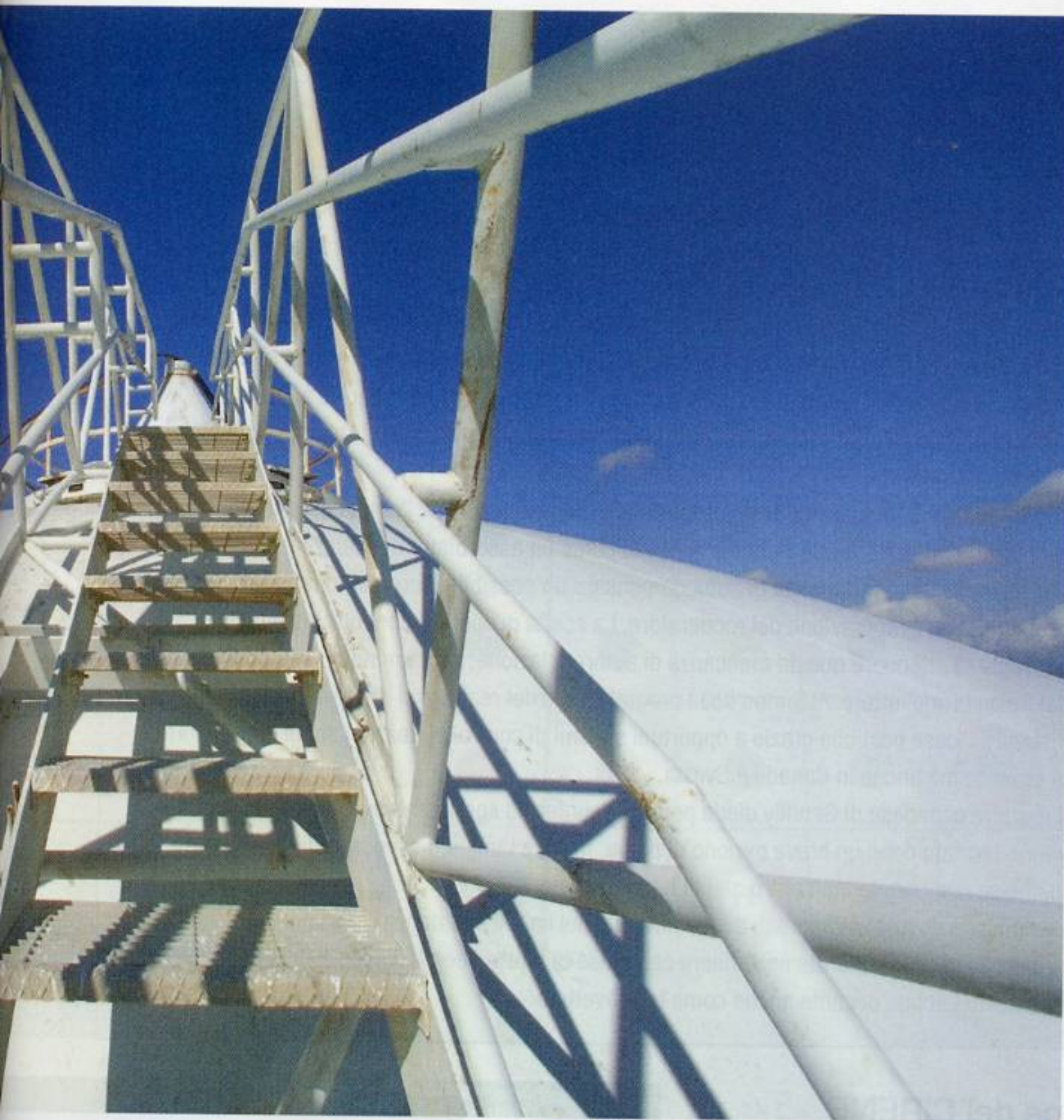
VISTO DA VICINO. Un particolare del contenitore di sicurezza dell'impianto prototipo CIRENE realizzato a Latina.
